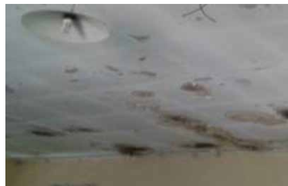
アパチの保健センターIIIの産科病棟の天井
